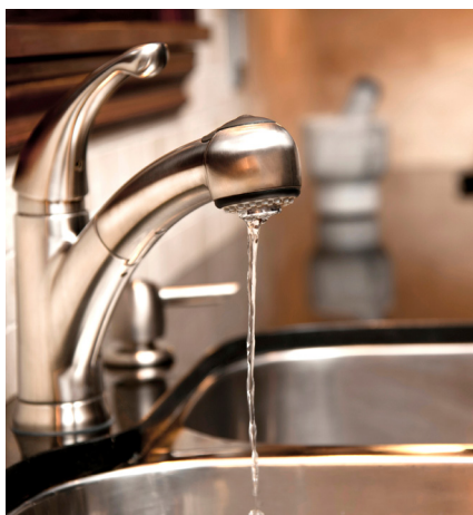
Gör en serviceanmälan om du har en droppande kran.
